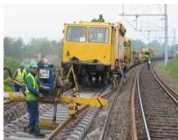
Longs Rails soudés sur traverses béton
